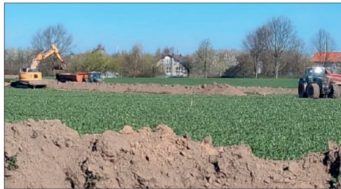
Zwischen Umgehungsstraße und bisherigem Gewerbe (Firma Hoffmann, Teach & Drive, Biogas-Anlage) finden die Erschließungsarbeiten für die Erweiterung des Unternehmerparks Broistedt statt.
